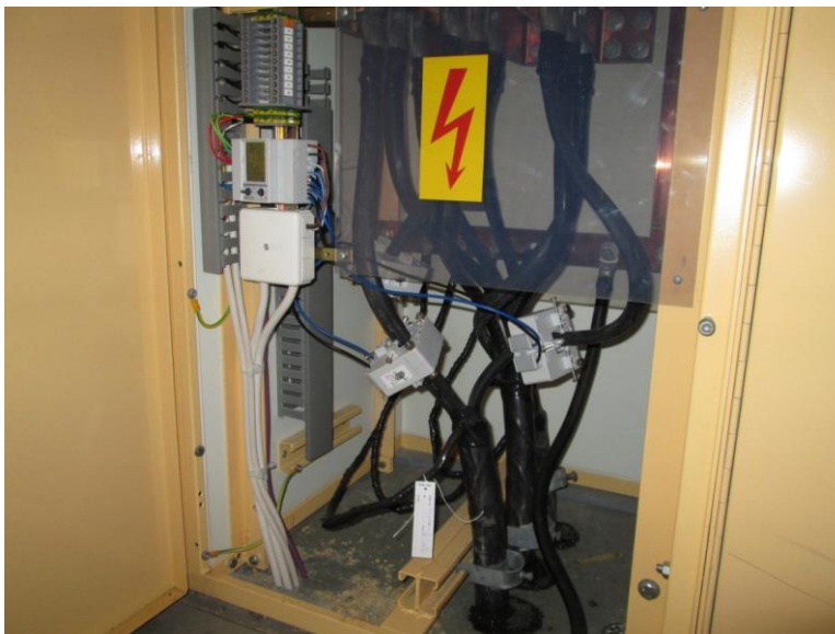
Figur 18: Energimätare (EM24) monterad på en ledare.
