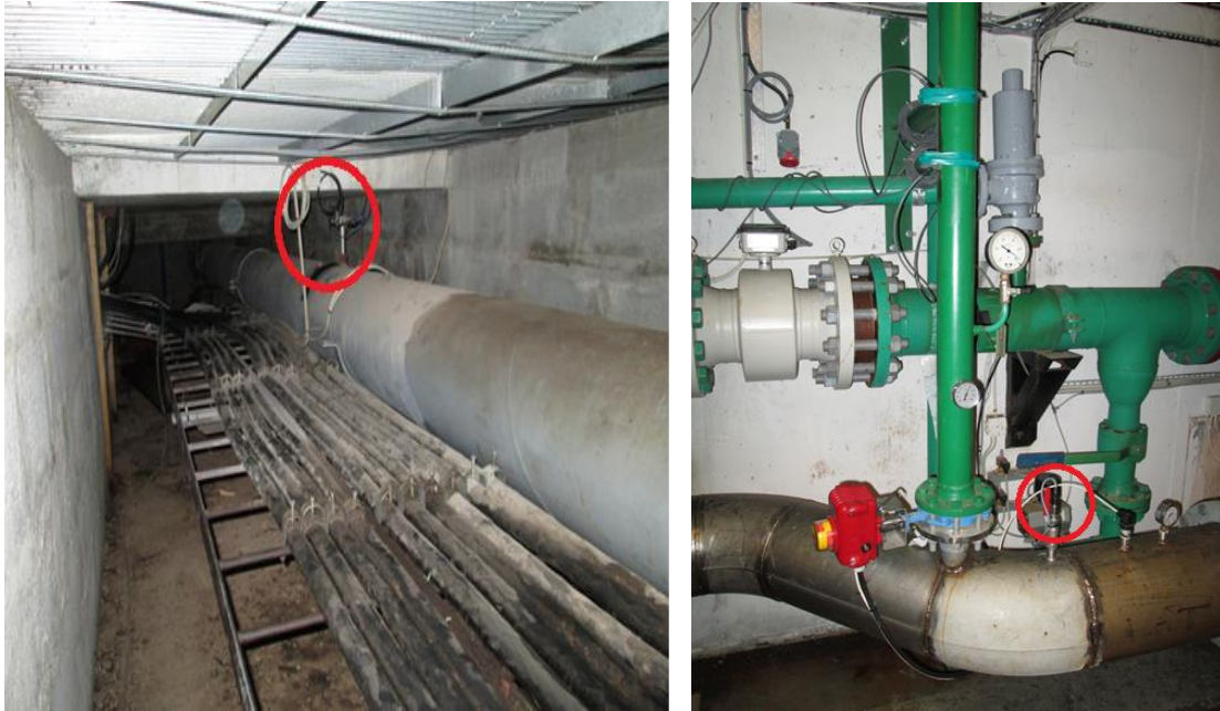
Figur 21: tryckgivare monterad på luft trycksida (t.v.) och vatten sug sida (t.h.).
