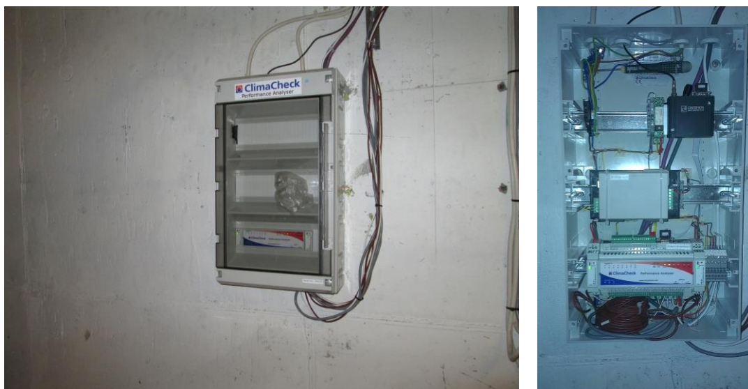
Figur 26: CC skåpet installerat i P2 huset.
