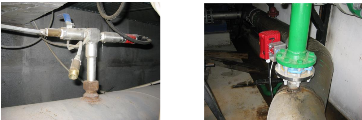
Figur 9: Tryckgivare potentiell anslutning på tryckluftsröret (t.v.) & kylvatten rör (grön-t.h.)
