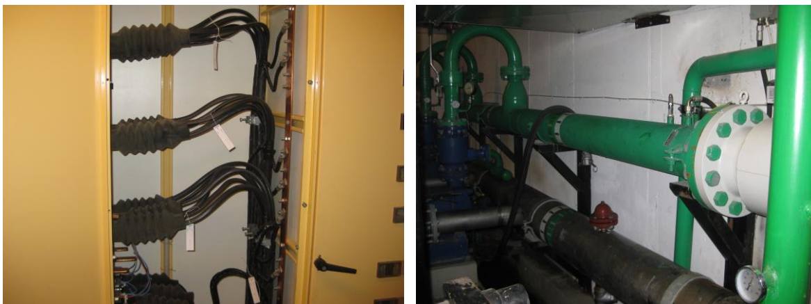
Figur 12: Matarkablarna till högtryckspumpar (t.v.) samt framledningsrör (t.h.).
