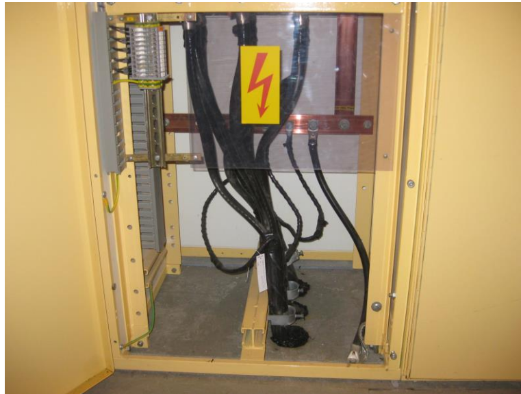
Figur 10: Mätningsskablarna till kompressorer.
