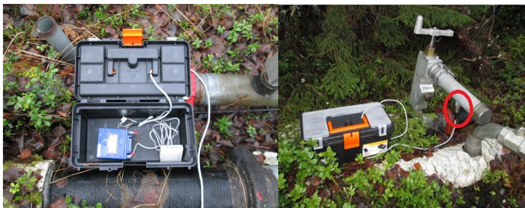
Figur 53: mätutrustning som användes för att möjliggöra tryckmätning (t.v.) & tryckgivaren på rören (t.h.).
