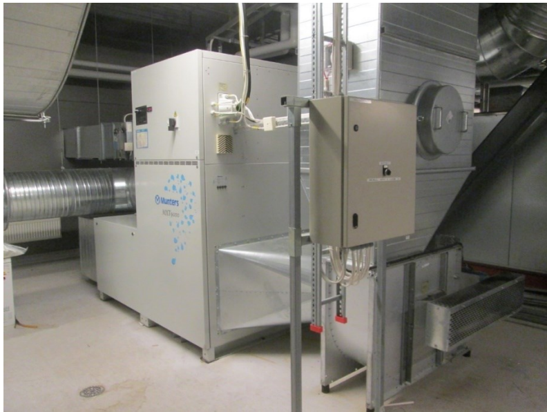
Figur 3. En större sorptionsavfuktare i en svensk arenaanläggning.
